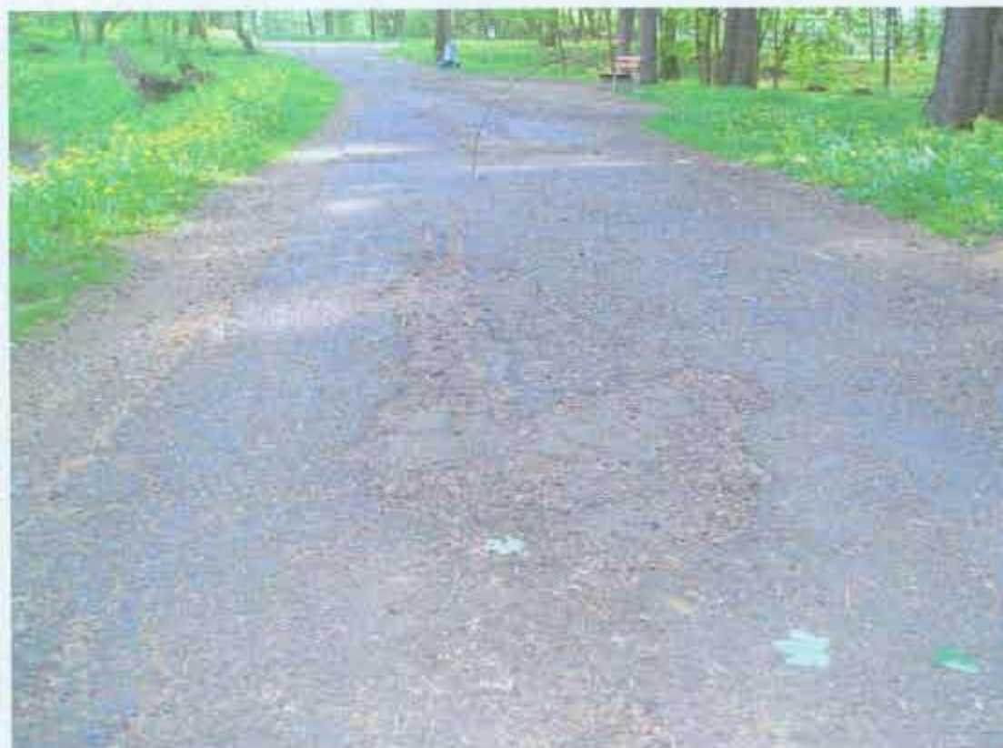
Wykruszenia nawierzchni alejki
